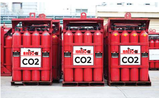
3. Hệ thống chữa cháy tự động khí CO 2
